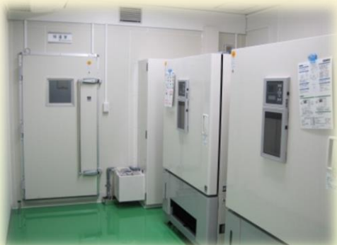
安定性試験室 (恒温室1台, 恒温恒湿器2台)
